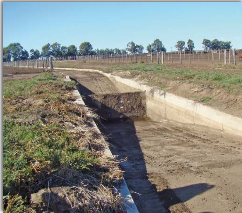
Canalizaciones de hormigón para evitar la infiltración de efluentes en las napas.
