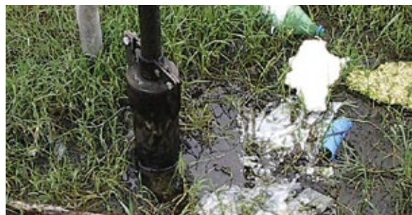
a. Mala construcción de una perforación con su boca en una depresión que puede favorecer el ingreso de contaminantes
