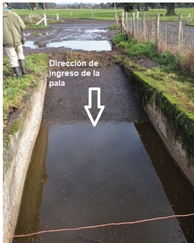
Figura 4.4 Decantador de sólido perteneciente a un establecimiento comercial de la provincia de Buenos Aires (Imagen, Ing. Agr. M. A. Herrero).
