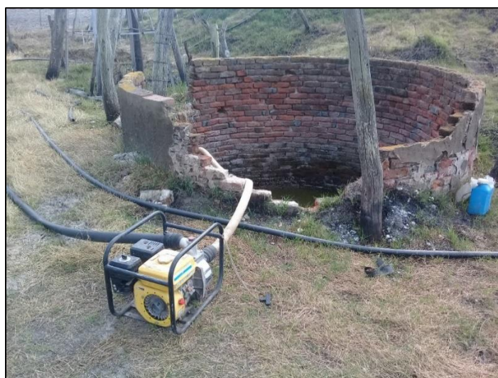
Pozo calzado que hay que reactivar y NO UTILIZAR MOTOBOMBAS PARA ESTE TIPO DE AMBIENTES.
