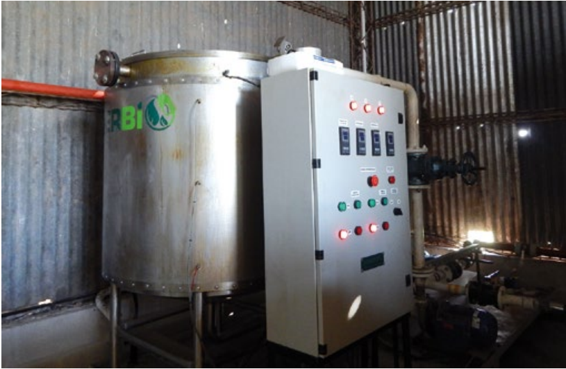
Planta de biodiésel de 500 litros/batch.
